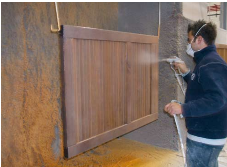
4 e 5 - Nell'applicazione a spruzzo, l'overspray è stato quasi eliminato. 4 and 5 – The overspray has been almost eliminated in the spray application.
